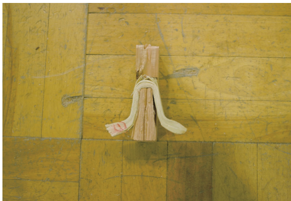
写真5 FFU込栓の変形
