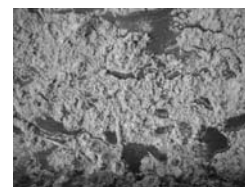
写真-10 壁土と合板の付着
