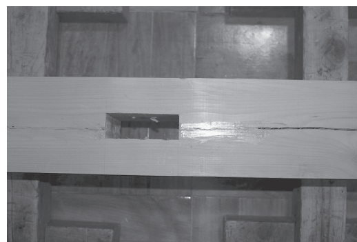
図2 HK-栓 18 の乾燥割れとエポキシ樹脂による補強処理
