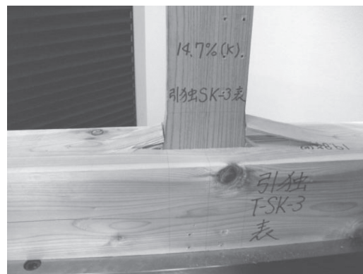
写真2 側材の上部割裂破壊
