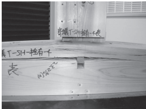
写真 5 寄せ蟻 栓有 栓上部破壊
