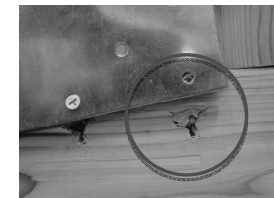
写真8 土台内部ビス折れ
