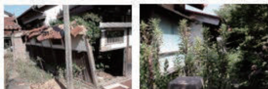
図20 安全面で問題のある倒壊の恐れがある空家屋
