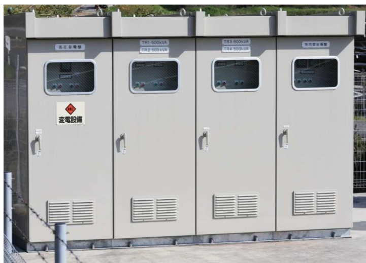
図 1 - 1 - 1 キュービクル式高圧受変電設備
