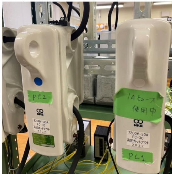
図1-2-9 高圧カットアウト
