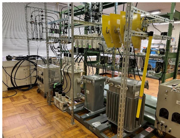
図 1 - 1 - 4 当設備 一次側
